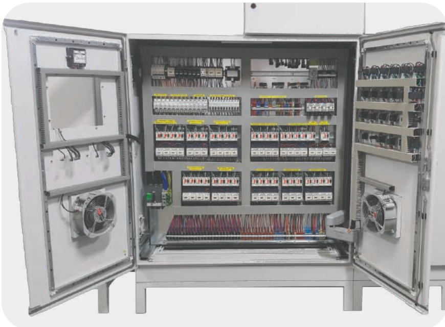
Şekil 23: Elektrik Panosu İç Görüntüsü
